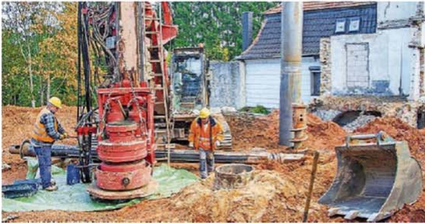
Die aufwendige Bohrpfehlgründung ist abgeschlossen und die Maurer können ihr Werk beginnen. FOTO: MICHAEL HASSDENTEUFEL
